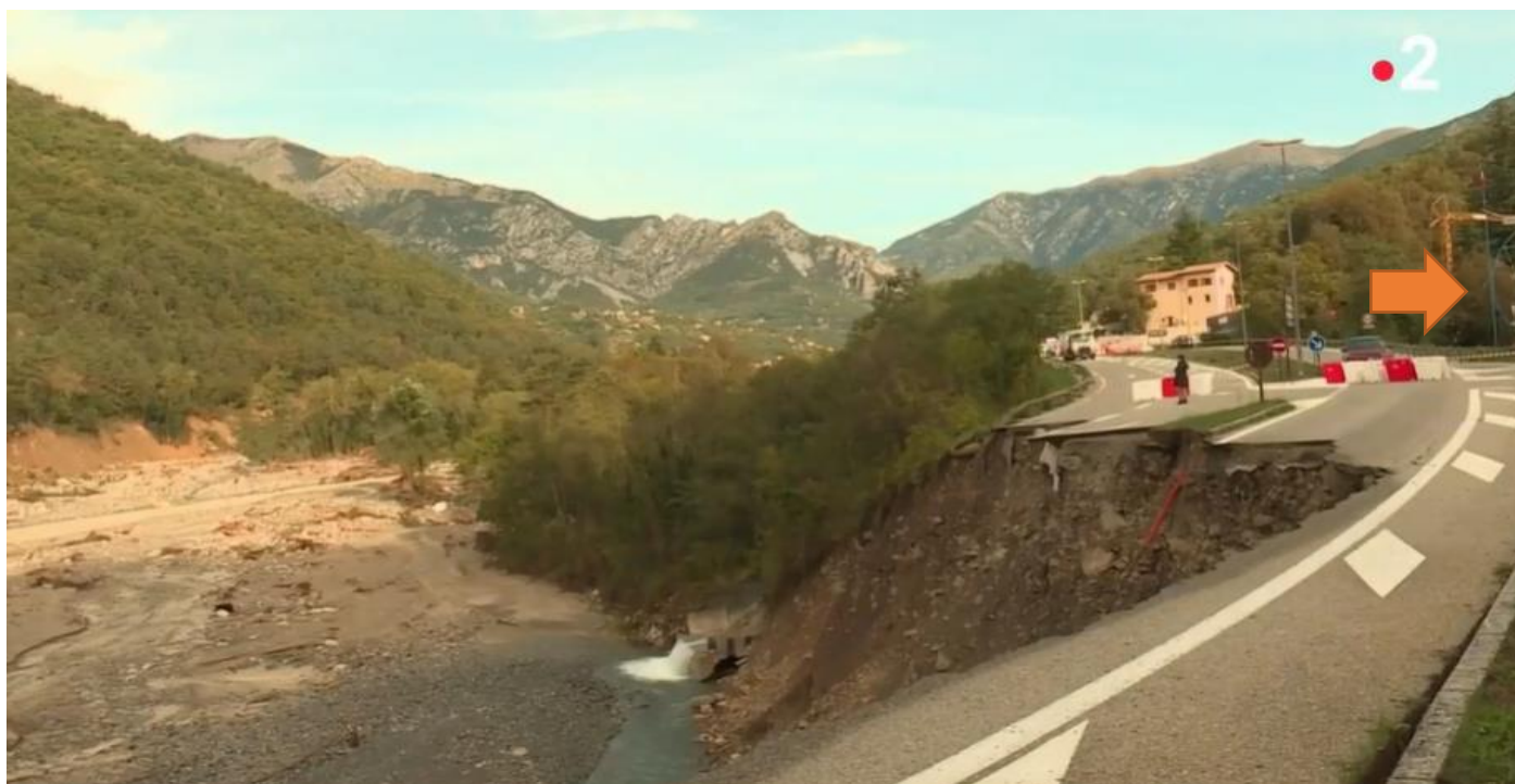
Capture d'image d'un reportage de France 2 montrant l'effondrement de la route, on aperçoit en haut à droite une partie du cercle du vélo (flèche orange).
